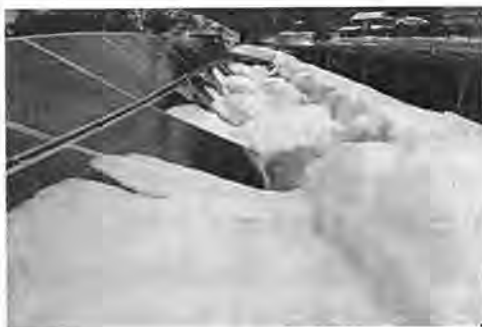
第4図 積雪によるPVSの圧壊事故例（2017年2月、鳥取県）
