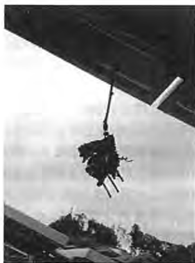
第 5 図 雷害で焼損・脱落した端子箱（2016 年 7 月、茨城県）（写真提供：被害者）
