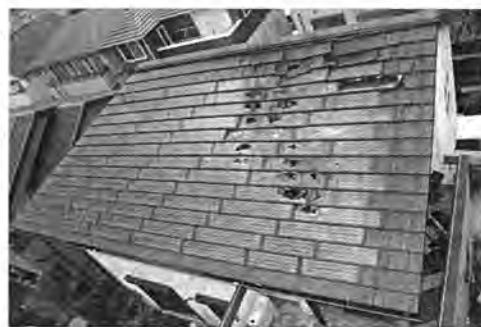
第 6 図 モジュールが出火原因とされている住宅火災事故（写真提供：被害者）
